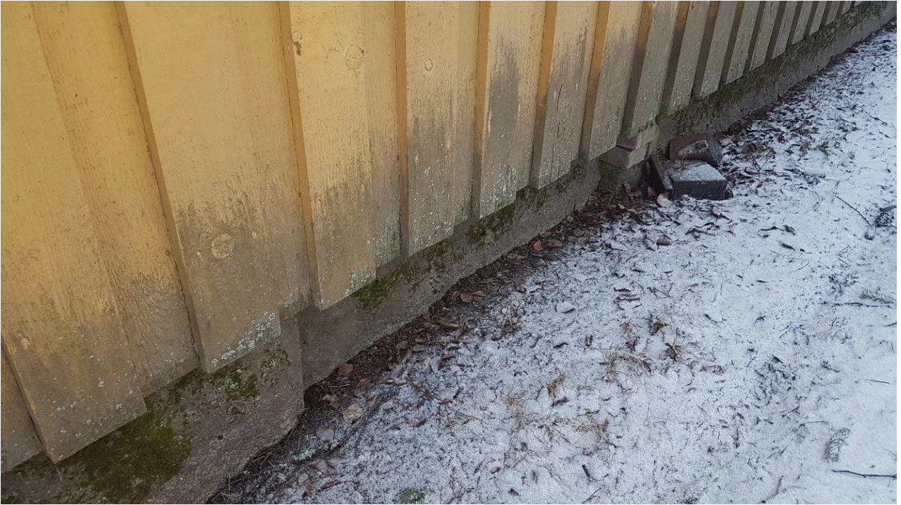
Takkasivulla porakiviä liikkunut
