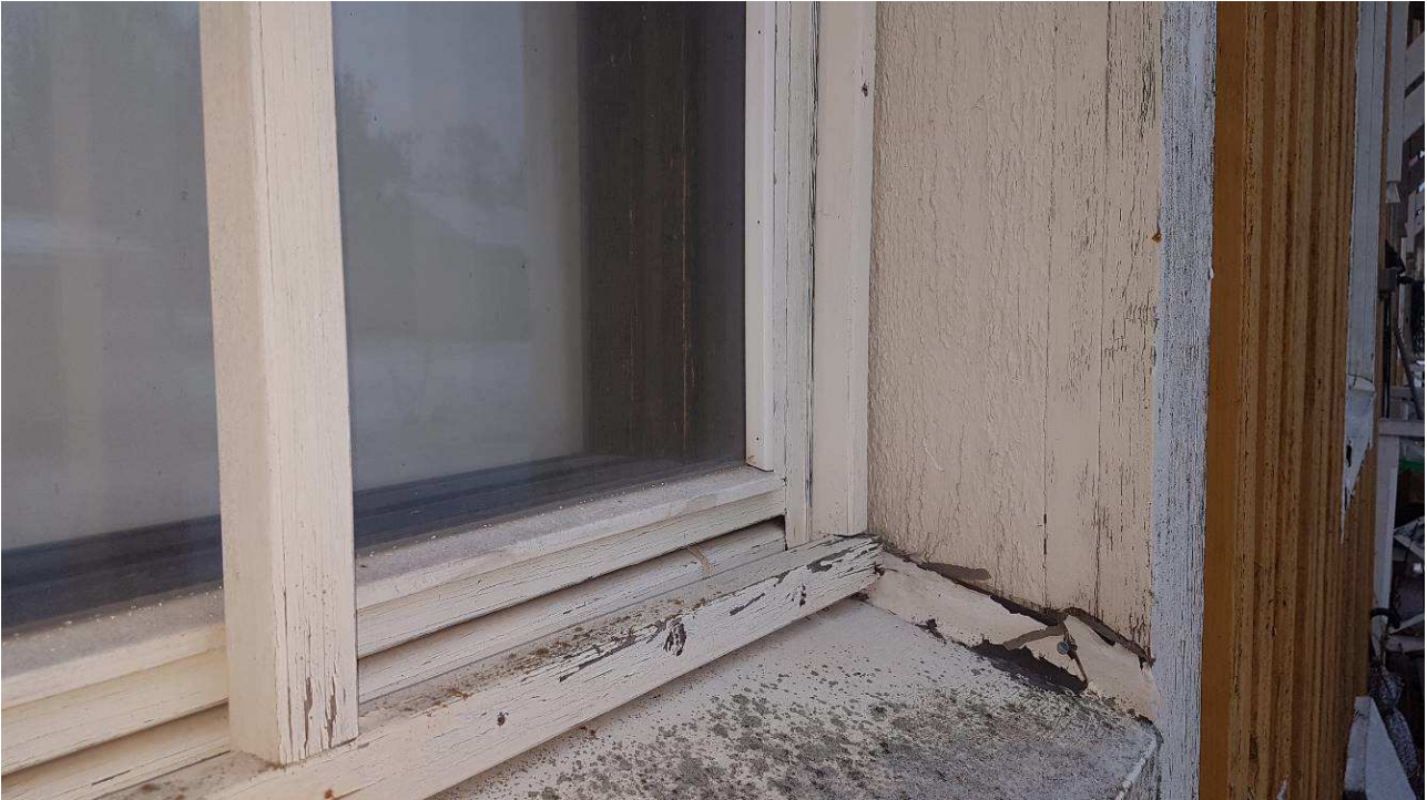
Ikkunoiden ulkopuolen maali kulunut
