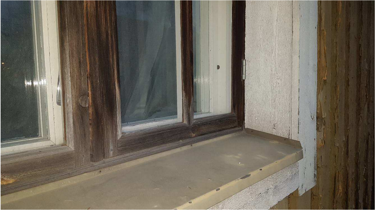
Ulkopuolella ikkunat kunnostuksen tarpeessa
