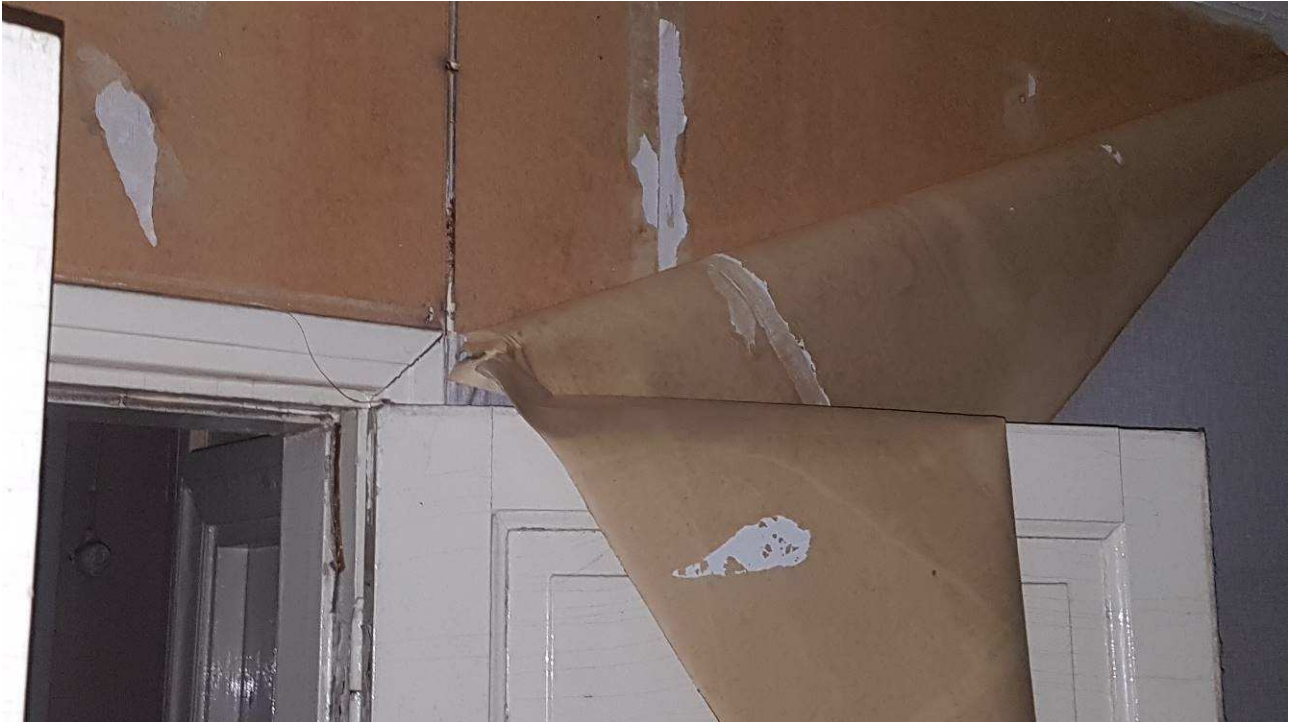
Sisäosat muutoinkin huonossa kunnossa
