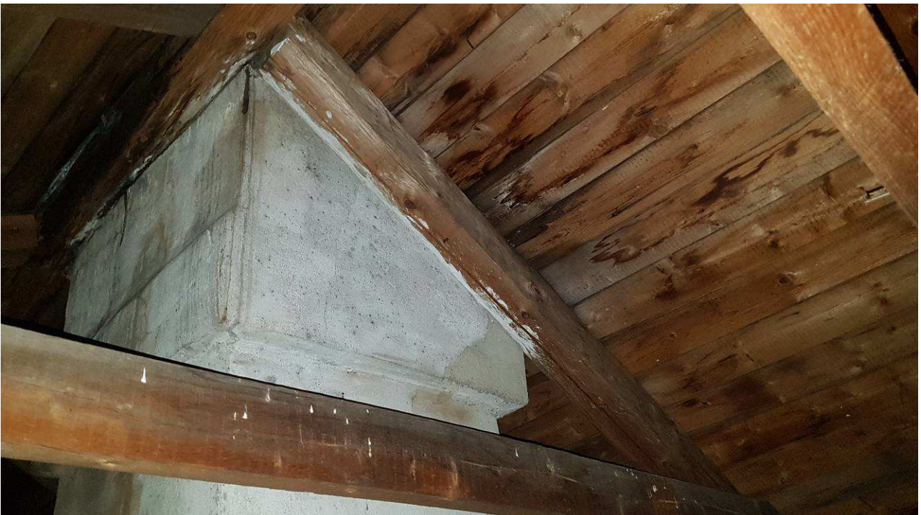
Ullakolla savupiippujen ympärillä vuotojälkiä
