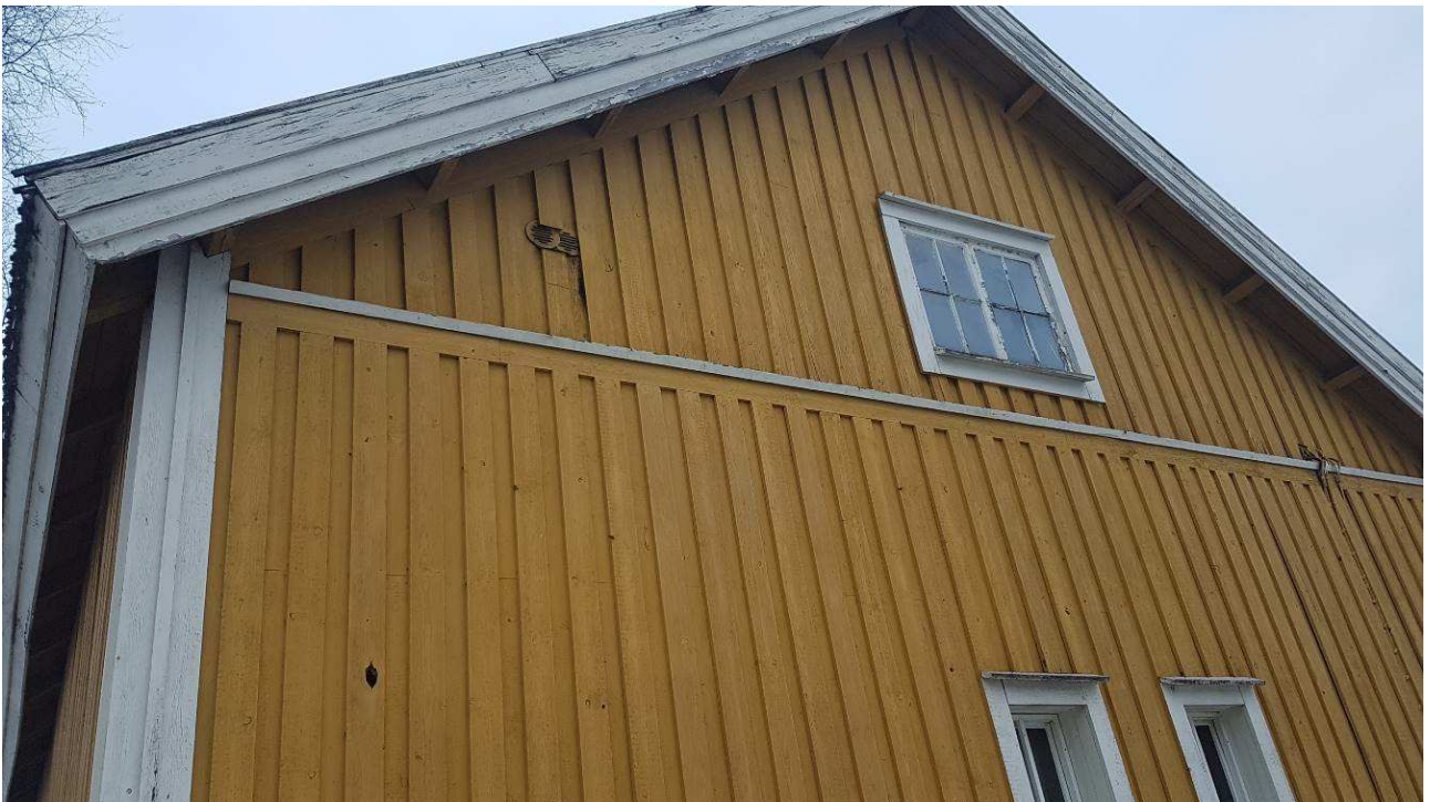
Otsalautojen maali kulunut
