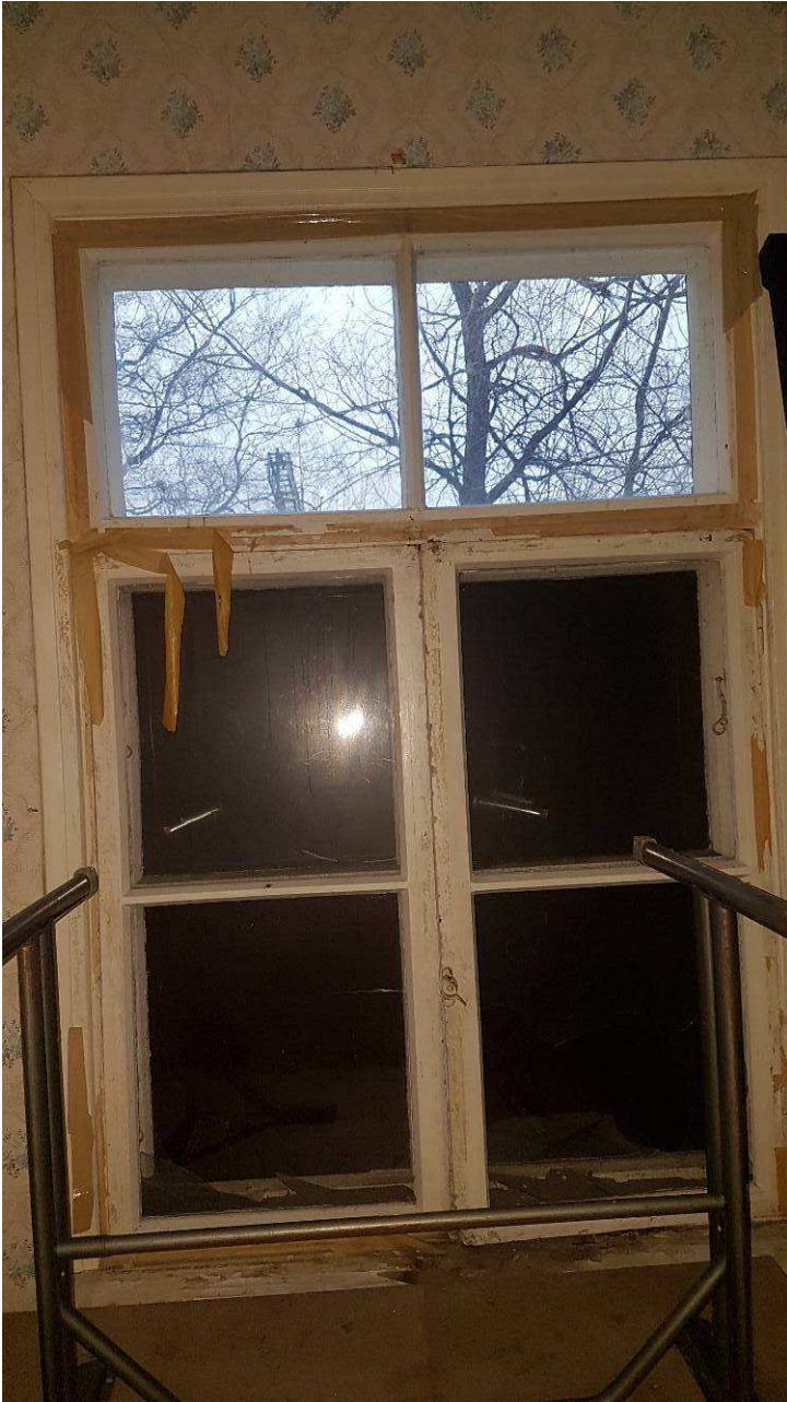
Ikkunat kunnostuksen tarpeessa
