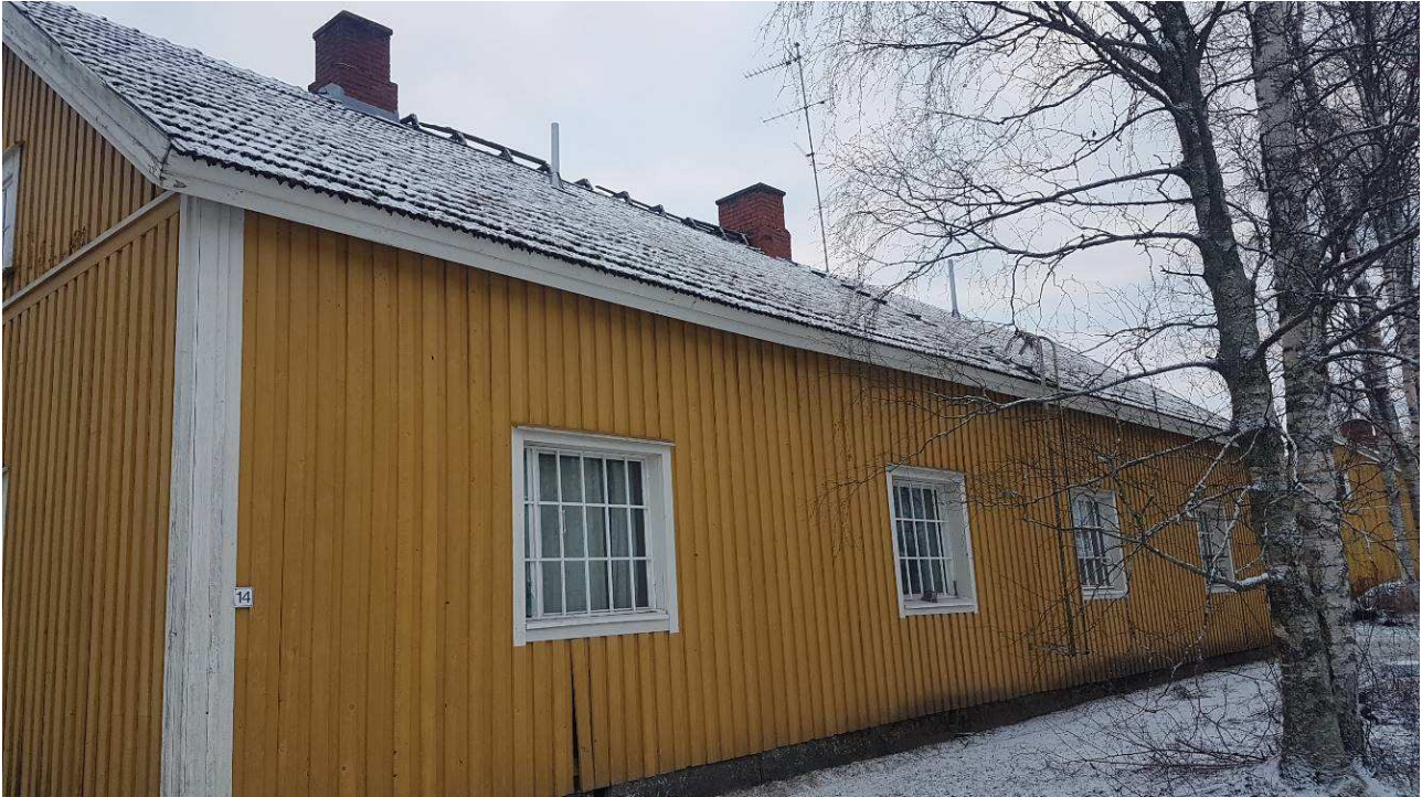
Takasivu maali kulunut
