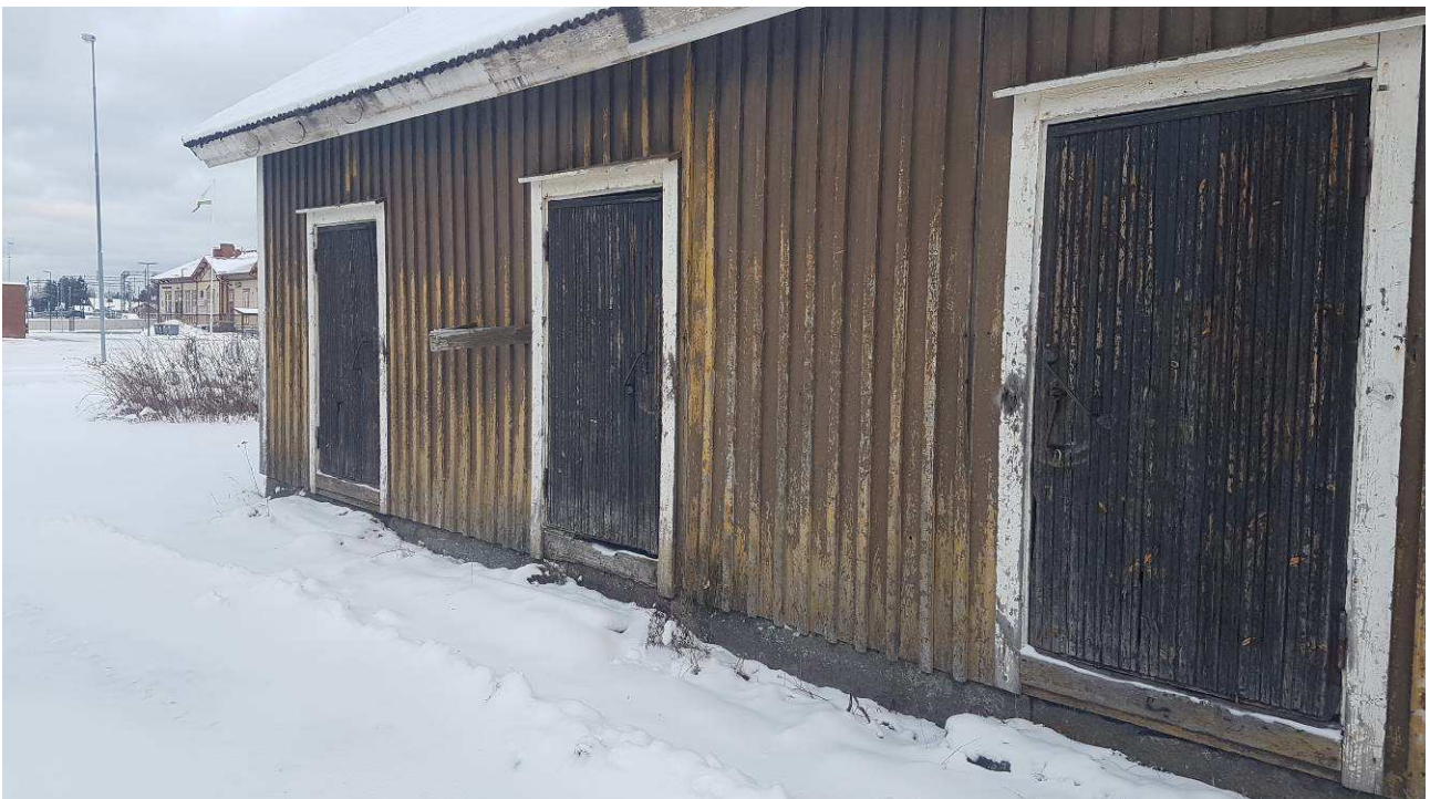
Muilla siseinillä maalipinta on huonokuntoinen
