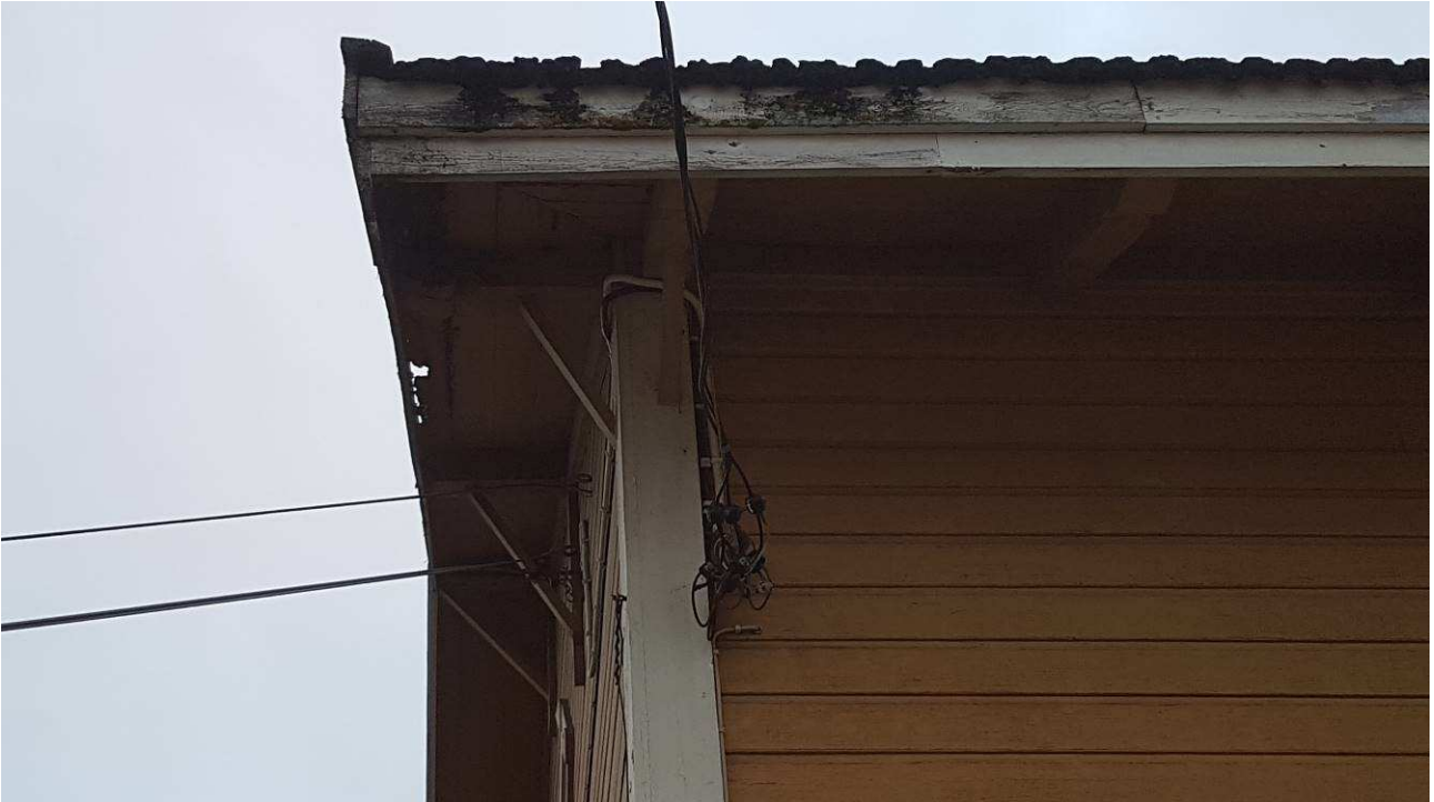
Vesikatto huonokuntoinen räystäissä ja otsalaudoissa lahoa
