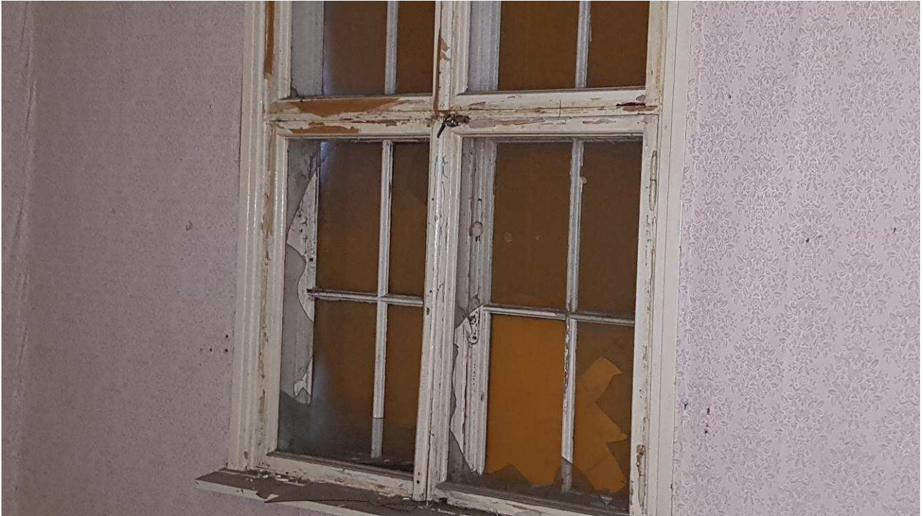
Ikkunat huonossa kunnossa
