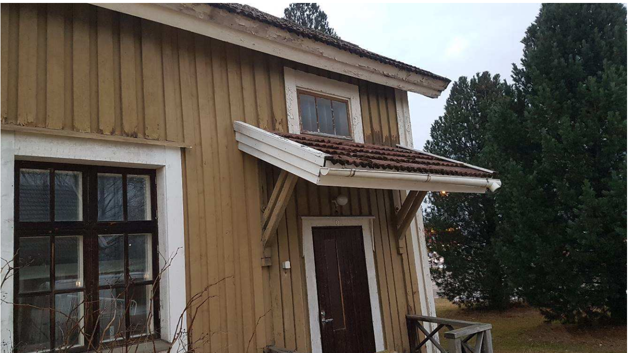
Oven lipan päältä puuttuu rintapelti
