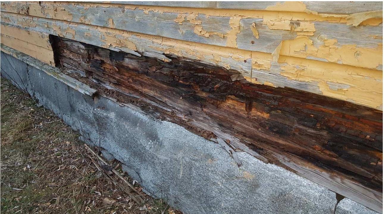
Oikea pääty alaosassa hirsissä lahoa
