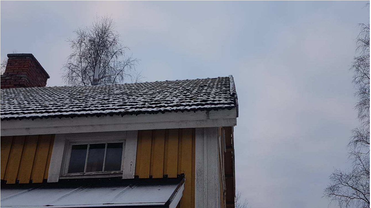
Tiilikatto on huonokuntoinen
