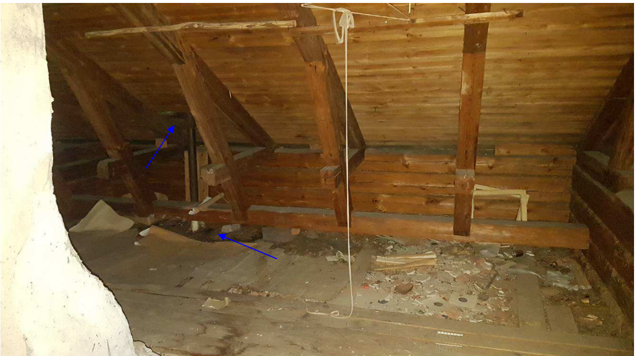
Viemärin läpiviennissä vuotojälkiä ja kosteusvauriota yläpohjassa
