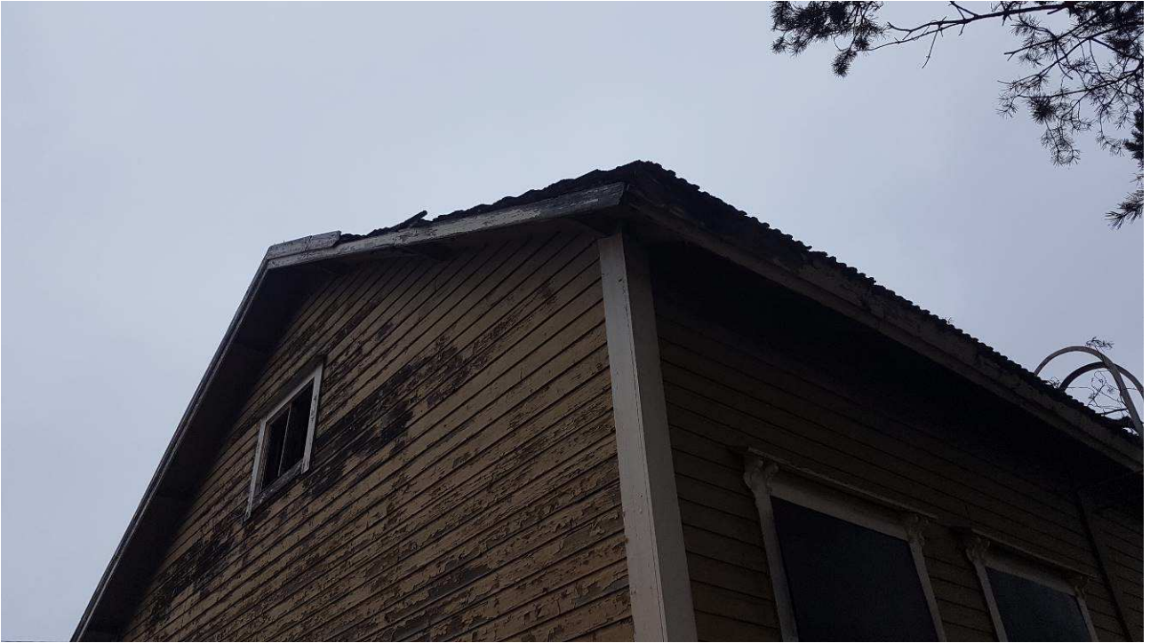
Räystäissä on lahovaurioita
