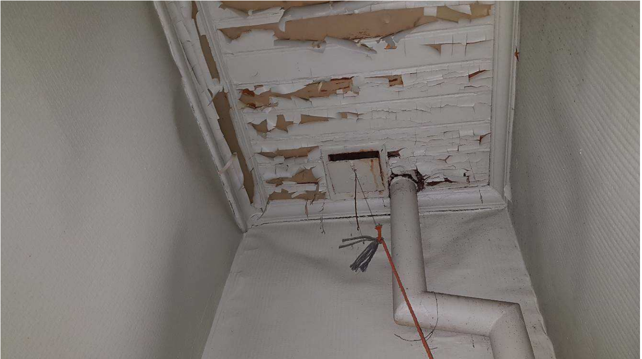
Vasemmanpuoleinen huoneisto wc:n katossa kosteusvaurio viemärin tuuletusputken ympärillä
