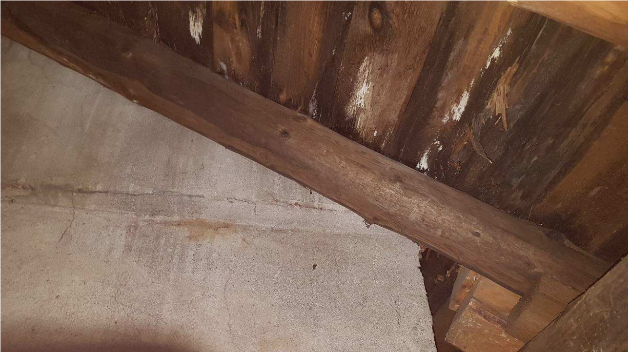
Ullakolla savupiipun juurissa vuotojälkiä.
