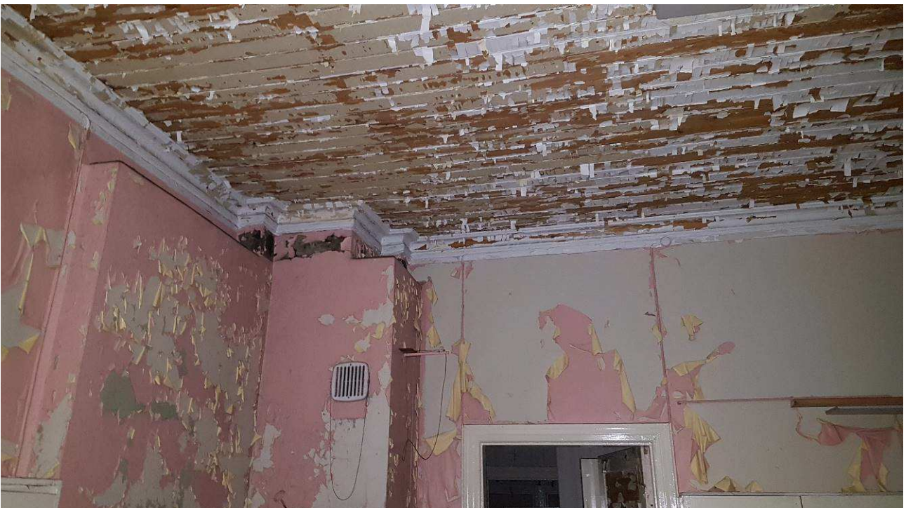
Sisäpinnat ovat huonossa kunnossa
