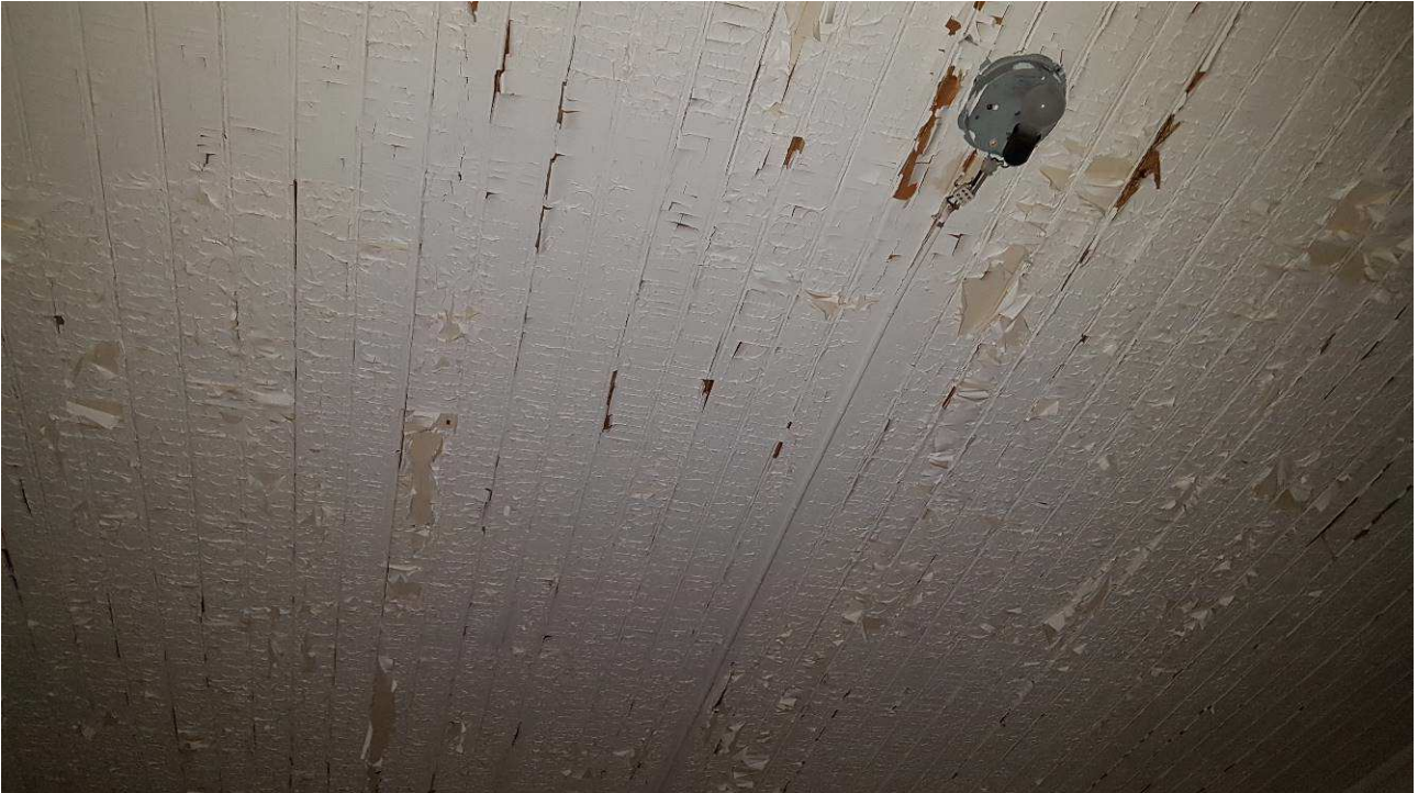
Maali hilseillyt katosta
