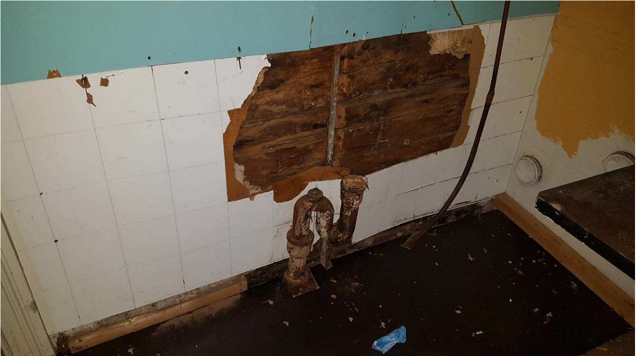
Keittiön kohdalla hirsiseinässä vaurioita
