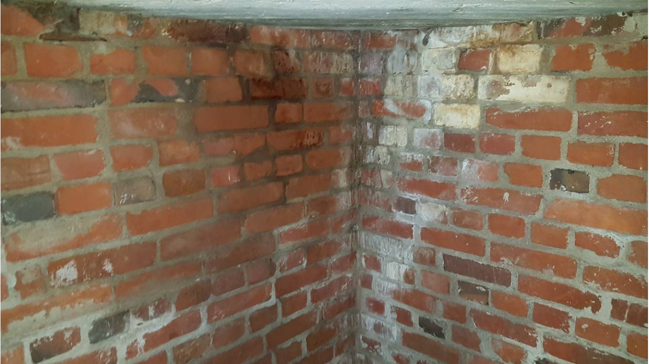
Tiiliseinän yläosa kosteana savupiipun juuren vuodosta.
