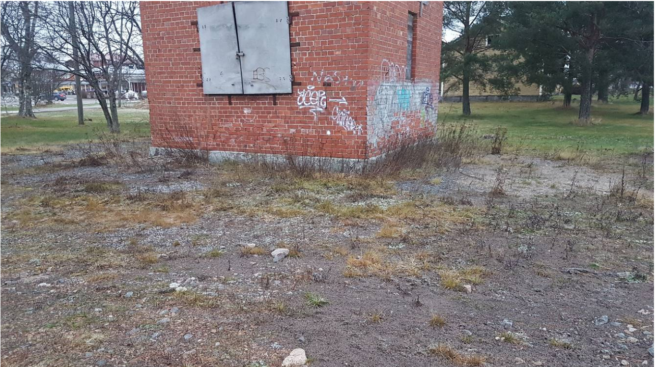
Takasivua sotkittu, risuja rakennuksen vierellä. Alaosan ikkunat rikottu
