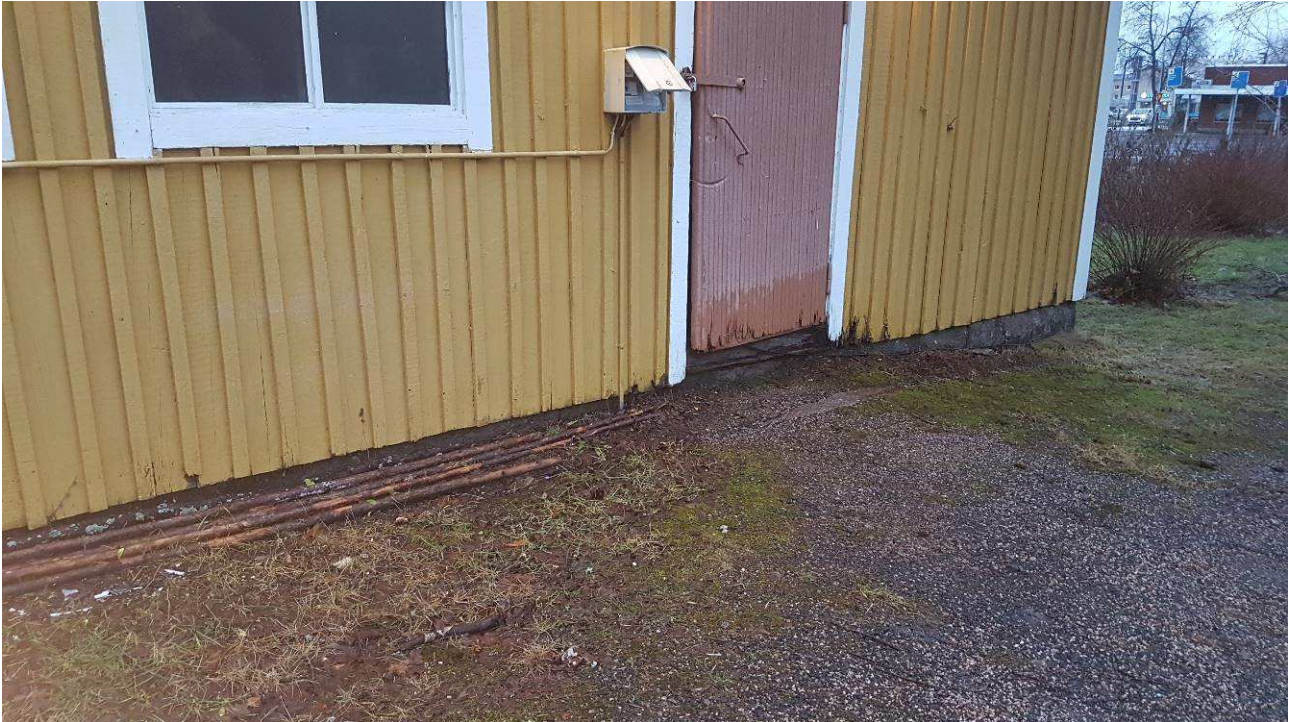
Junaradan sivu on malattu, alareunassa on lahovaurioita
