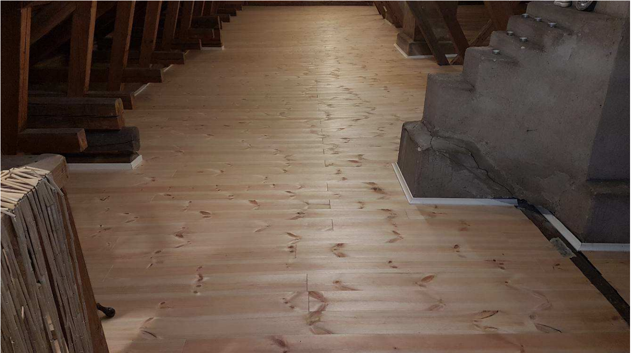
Ullakolle on tehty lankkulattia, Hormissa halkeamia
