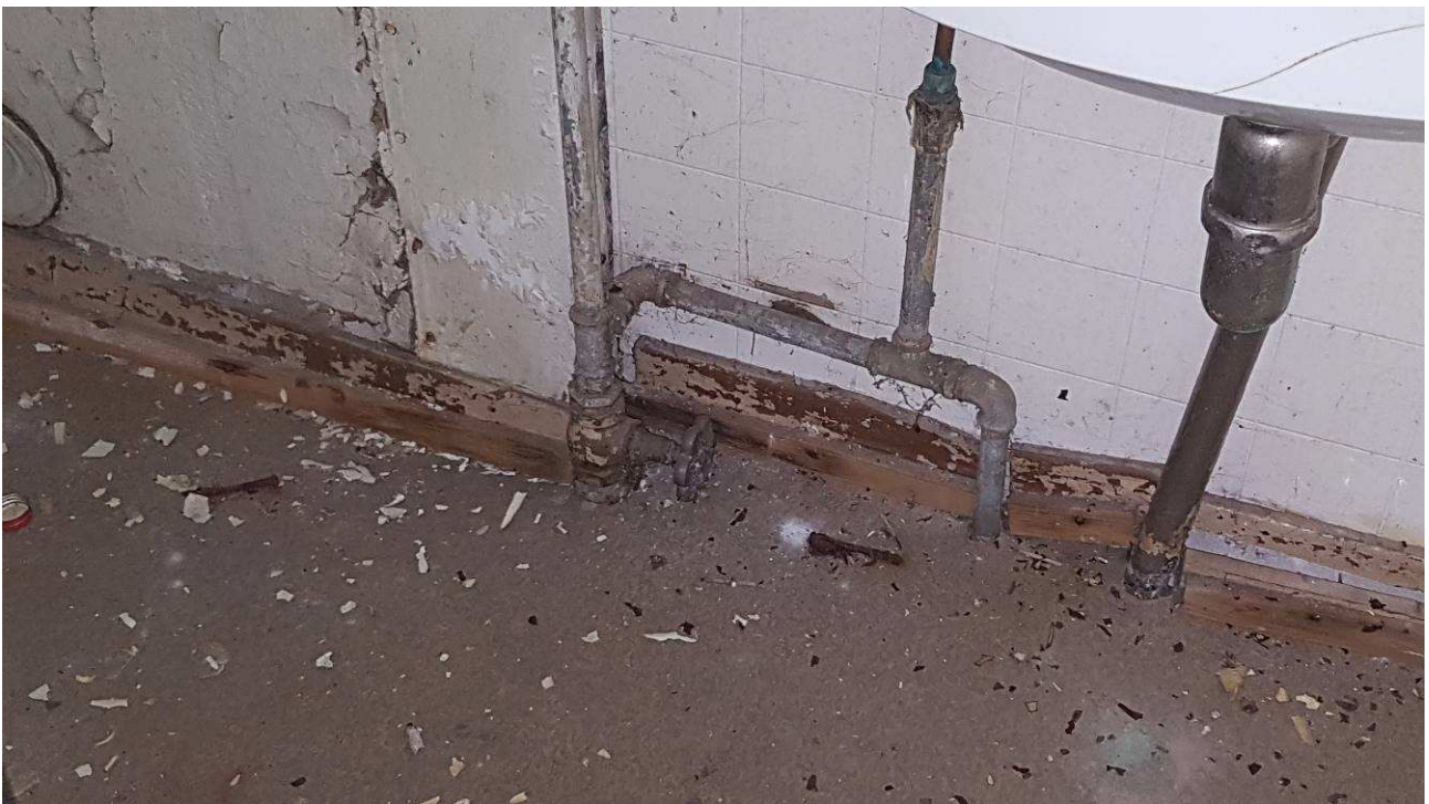
Käyttövesi putket vanhat
