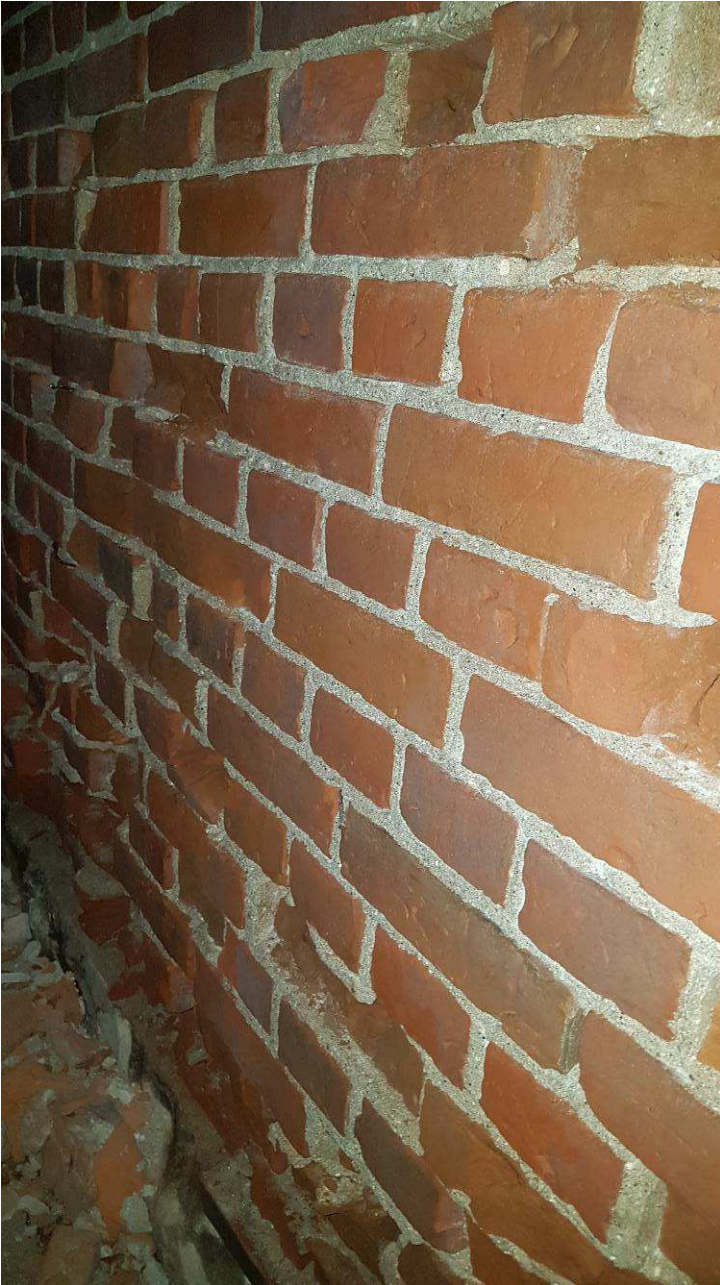
Sisäseinä pullistunut sisälle päin
