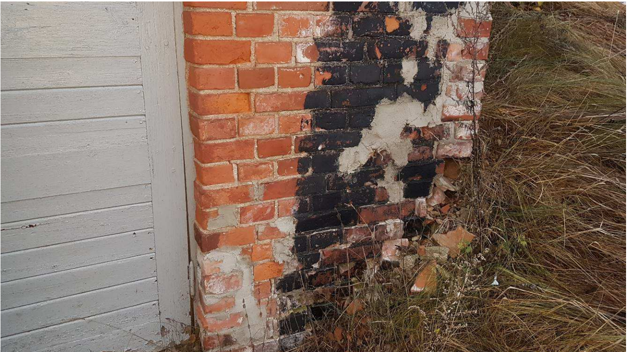
Ulkoseinissä on lohkeamia ja halkeamia
