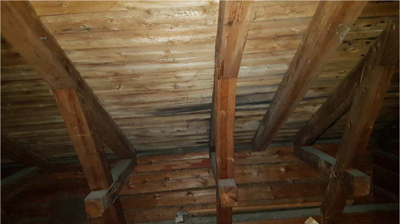
Katon aluslaudoissa muutamia muitakin vuotojälki kohtia
