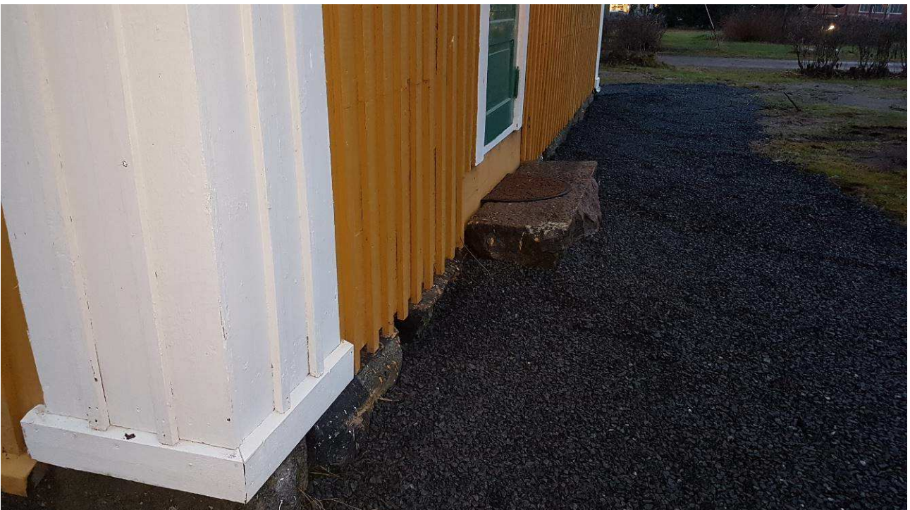
Pohjois päädyssä ei ole alalankku
