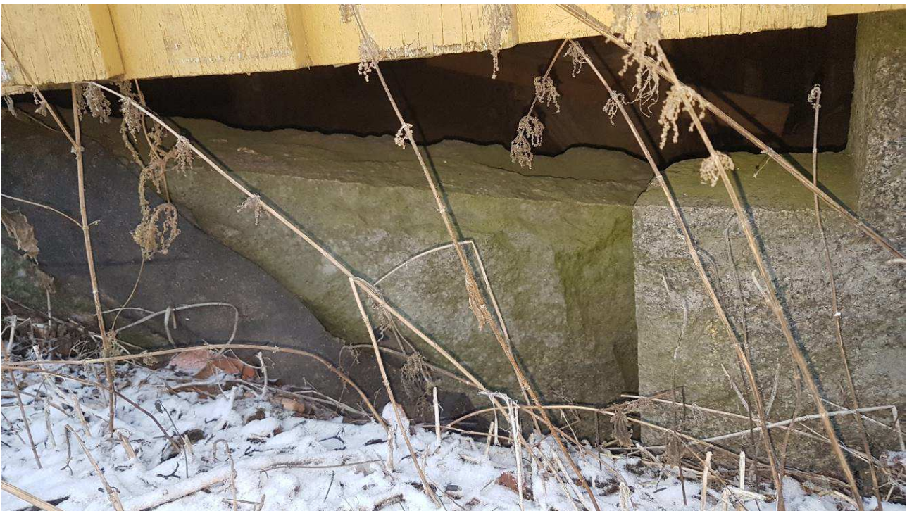
Oikeassa päädyssä porakivi painunut
