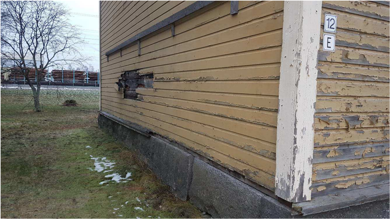
Ulkovuorella on reikä, alalankuissa lahovaurioita. Perustus on pysynyt hyvin paikoillaan.
