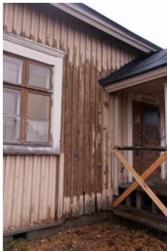
Kuistin räystääsvedet ohjautuvat julkisivuverhouskeeseen
