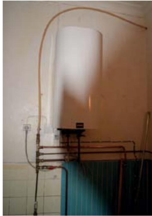
Kuva E36 Vessan vesivaraaja 2000-luvulta, putkiveto kulkee makuuhuneen kautta keittiöön (H110)
