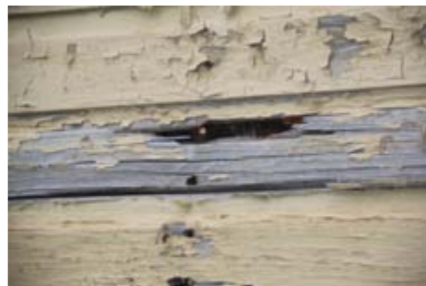
Q: Julkisivu laudoituksessa on paikoin isompi lahovaurio johon on syntynyt jopa reikä.
