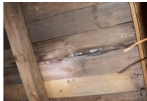
Kuva 4. Vesikaton vuotokohdasta aiheutunut pieni kosteusvaurio katteenaluslaudoituksessa.
