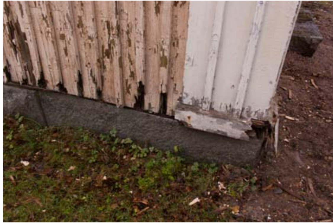
Nurkkalautoitus on vaurioitunut ja vaatii välitöntä korjausta. Vesilauta puuttuu osittain rakennuksesta kokonaan.
