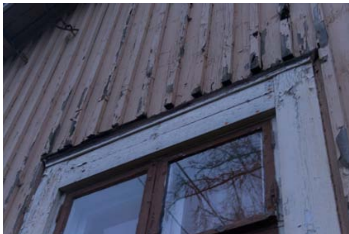
Ikkunan koristelista puuttuu
