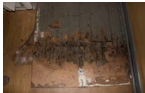
Kuva 6: vaurioitunut alapohja ennen pohjan aukaisua
