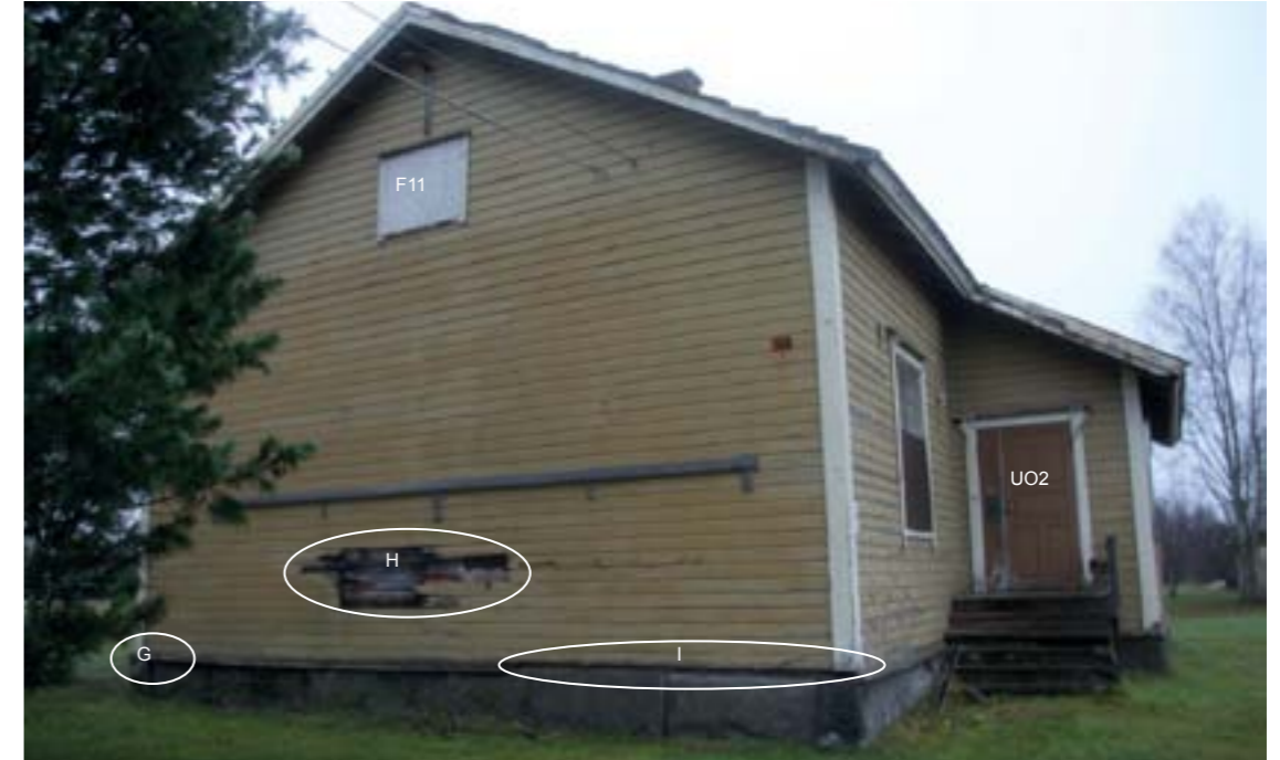
Pohjoisjulkisivu on muuten aika hyvässä kunnossa, mutta siellä on huomattava paikallinen vaurio julkisivun alaosassa.
