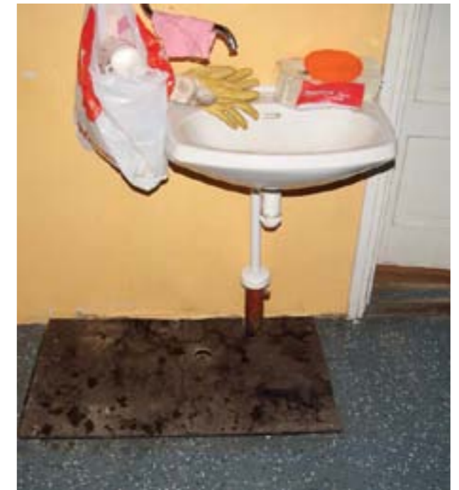
Kuva E21 Keittiön lavaari. Toiminnallisesti epäkäytännöllinen wc-lavaari keittiössä, lavaarin alle kiinnitetty rakennuslevy mahdollisesti paikkaamaan asennustyön jälkiä (H107)
