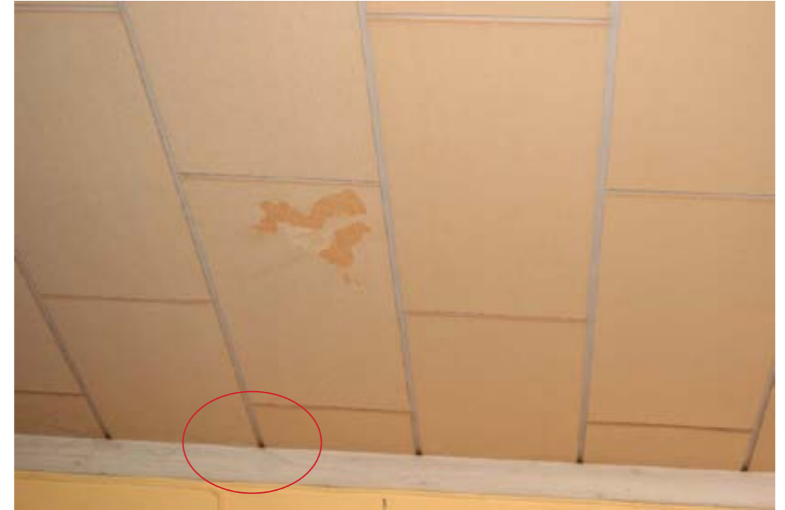
Kuva E19 Keittiön kattopaneelin pinta rikkontunut, kattolistan maali halkeillut, listan takana havaittavissa kosteusvauriota (H 107)
