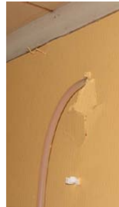
Kuva E 20 Vesijohtoveto keittiön puolelta tehty tökerösti rikkoen pintamateriaalin (H107)
