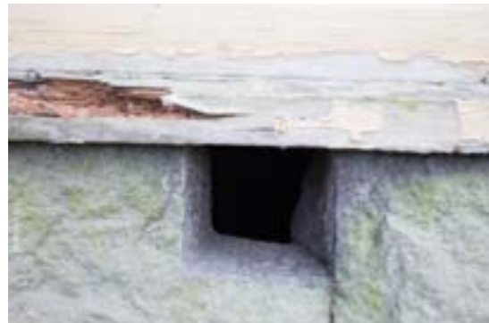
Kuva 3: tuuletusaukko ja vaurioitunut vesilauta
