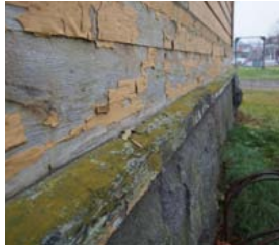
Liite 4: Ulkoseinän kahdesta alimmasta vuorilaudasta on maali hilseillyt ja vesilauta on sammaleessa.
