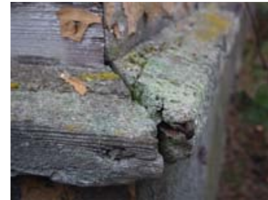
Liite 7: Vesilautojen liitokset irvistelevät ja nauvoja on työntynyt ulos.
