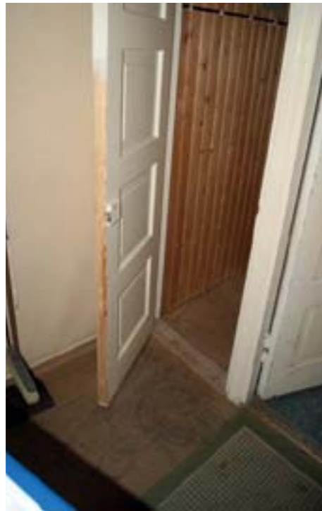
Kuva E13 Eteisen komeron ovi höylätty jälkikäteen (H102)
