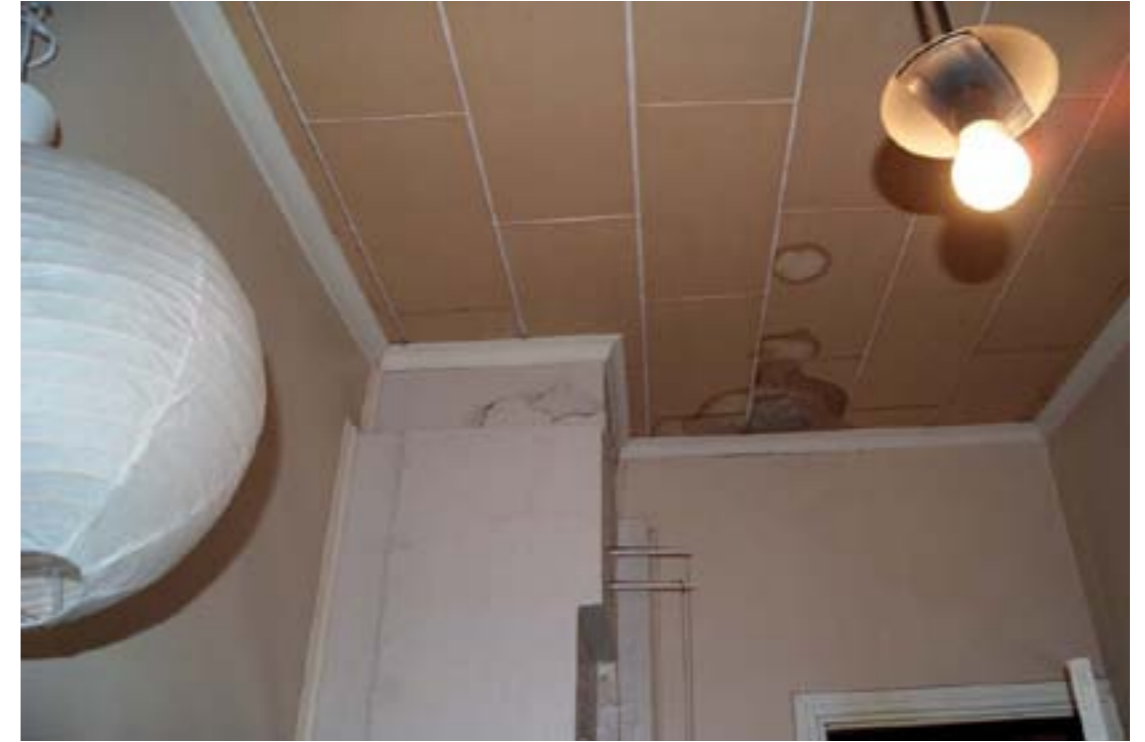
Kuva E26 Laaja kosteusvaurio huoneen 108 katossa. Mahdollisia homevuriota (H108)
