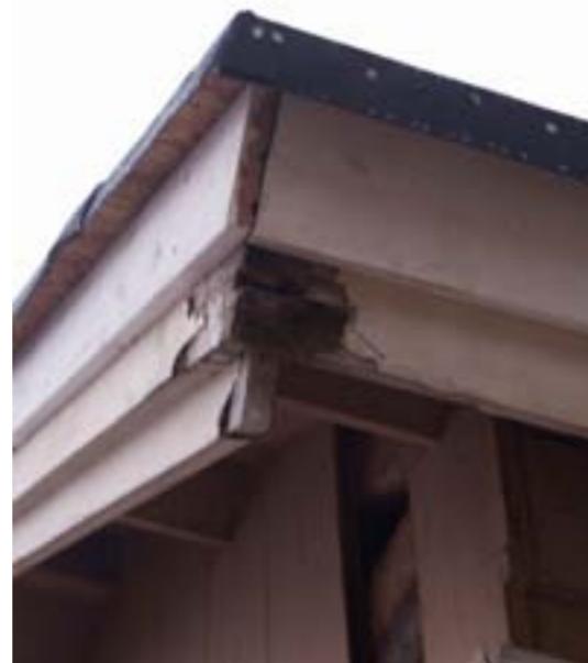
Katon korjauksen yhteydessä uusittujen räystäslautojen päät ovat käsittelemättä. Pintakäsittely tarvitaan välittömästi, jotta jo kunnostetut osat eivät lahoa.
