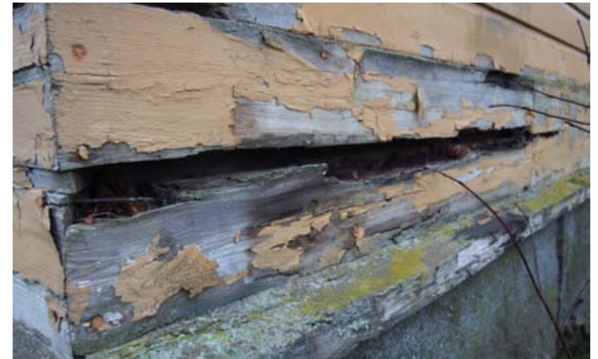
Liite 3: Syvä lahovaurio pohjoisjulkisivulla.
