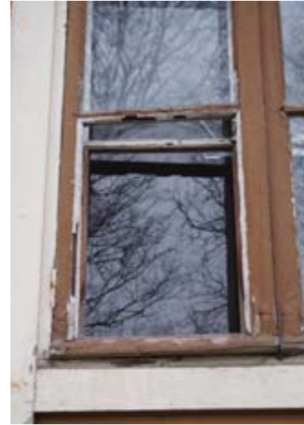
Liite 2: Ikkunalasi särkynyt, kittaus lohkeillut ja irronnut.
