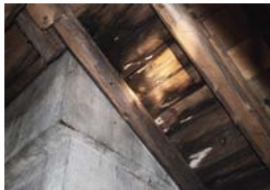
Kuva 3. Kosteusvaurio etelän puoleisen hormin ja vesikaton liitoskohdassa.
