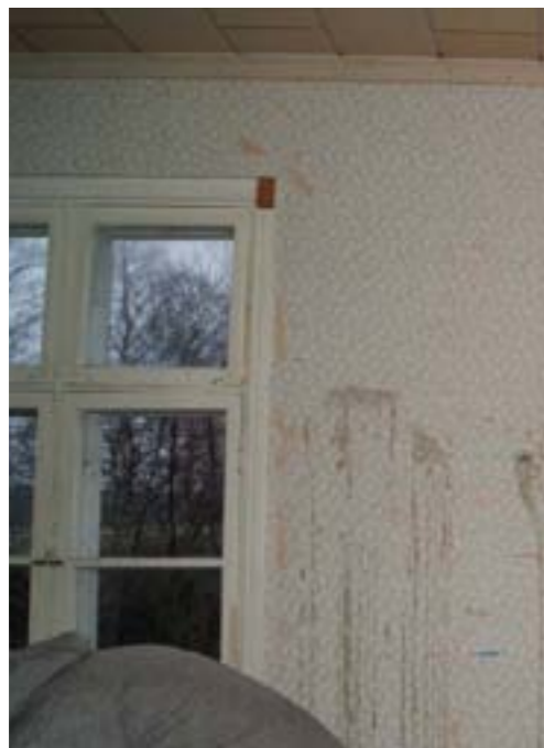
Kuva E10 Herran huoneen tapetti rähjäinen (H103)
