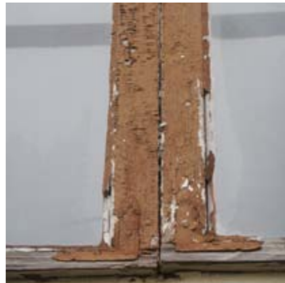
Liite 4: Maali hilseillyt erityisesti puitteen alasarjasta. Myös kittauksen huono kunto näkyy.
