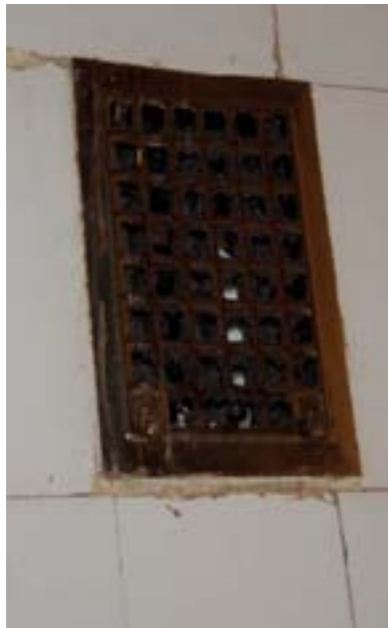
Kuva E24 Hellan hormissa kaunis likainen tuuletusristikko. Hormin pintamateriaali jäljittelee laatoitusta ja on rispaantunut (H107)
