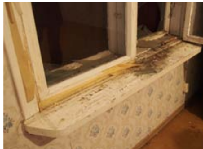
Liite 6: Jälkikäteen lisätty ikkunalaus. Liimapaperinauhat lisätty vähentämään vedontunnetta.
