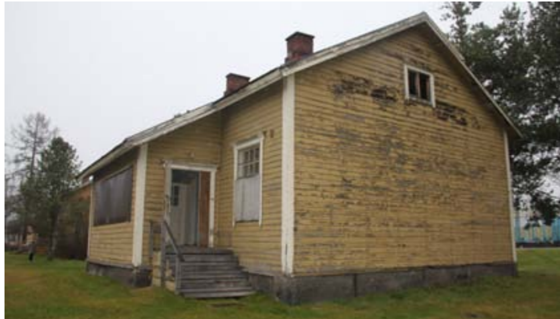
Julkisivujen kunto vaihtelee suuresti ilmansuunnista riippuen. Kuvassa näkyy etelä- ja länsijulkisivut, joista eteläjulkisivu on huomattavasti kuluneempi.
