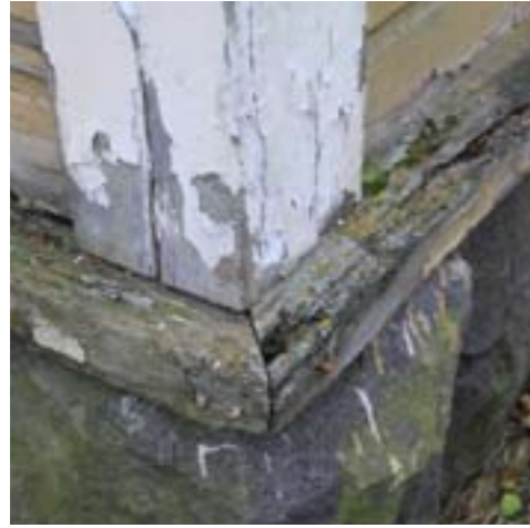
G: Nurkkalautojen alapäävät ovat kosteusvaurioiset, osittain lahot ja halkeilleet. Joudutaan ainakin osittain uusimaan.
