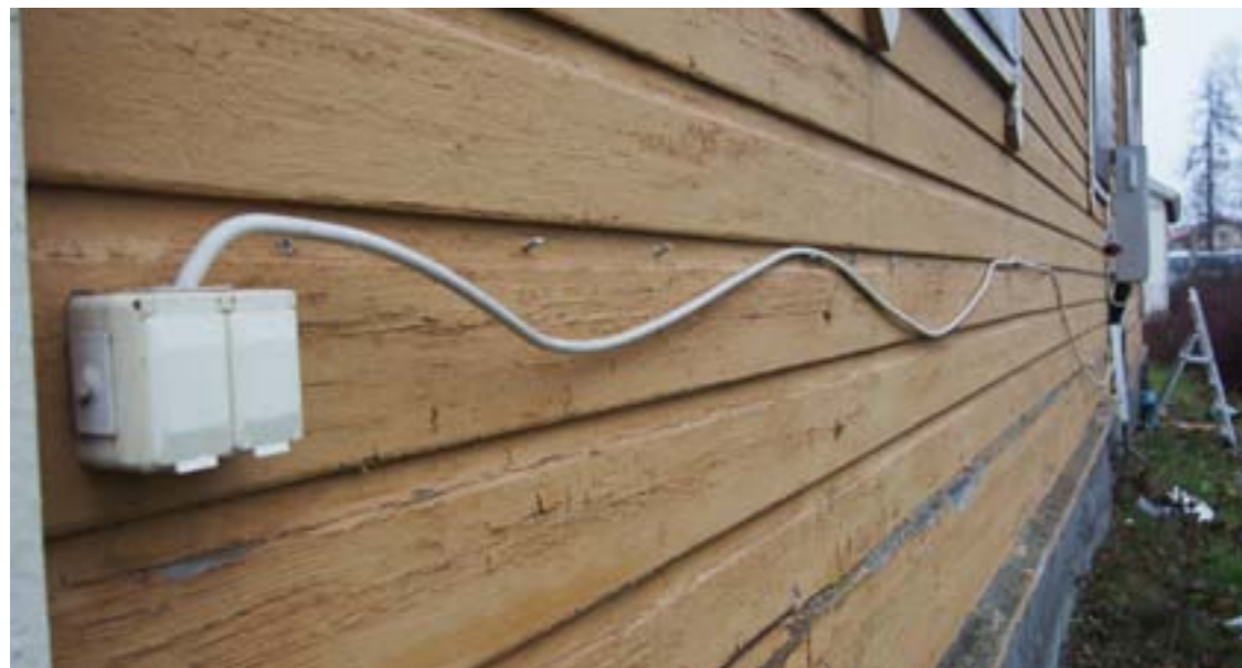
Liite 6: Irronnut sähköjohto roikkuu pitkin seinää.
