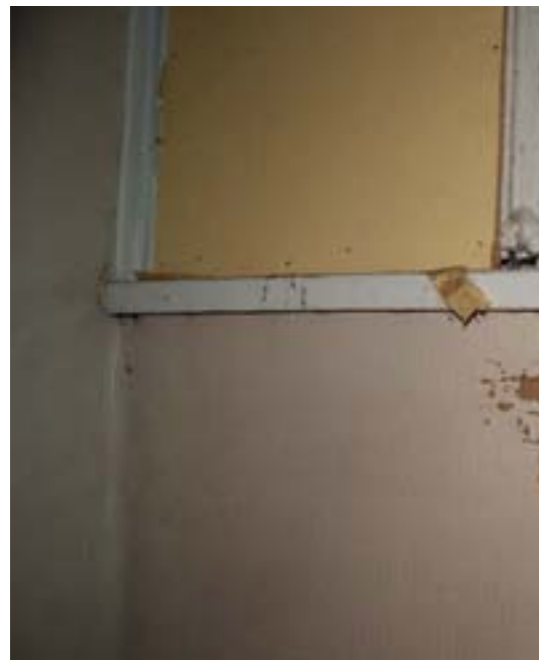
Kuva E30 Ikkunan lasi rikkoutunut ja paikattu karskisti rakennuslevyllä (H108)
