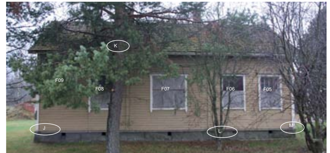
Julkisivu itään. Päällisin puolin julkisivu on suhteellisen hyväkuntoinen. Vieressä oleva mänty on kasvanut liian lähelle rakennusta mikä aiheuttaa ongelmia etenkin rakennuksen yläosassa. Männystä pitäisi ainakin poistaa rakennuksen lähelle tulevat oksat, tai kaataa koko mänty.
