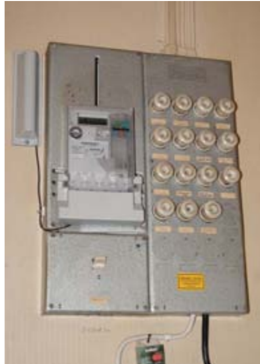
Kuva E14 Eteisen sähkötaulu (H102)
