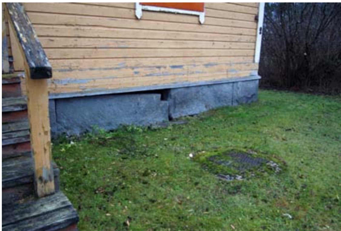
Liite 3: Sokkelin kivi ja maa sen edessä on painunut.
