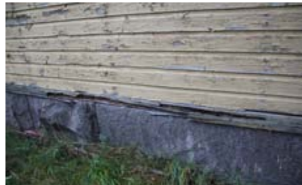
P: Alahelman vesilista kauttaaltaan huono kuntoinen, osittain laho ja osittain jo puuttuu kokonaan.
