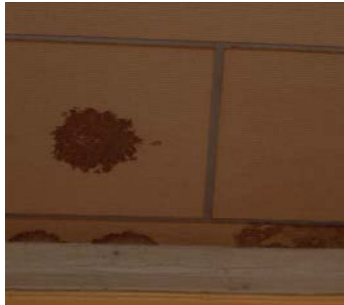
Kuva E25 Kosteusvaurioita keittiön katossa. Vaurio jatkuu huoneen 108 puolelle. Kattolistojen maali vaurioitunut kosteuden johdosta (H107)
