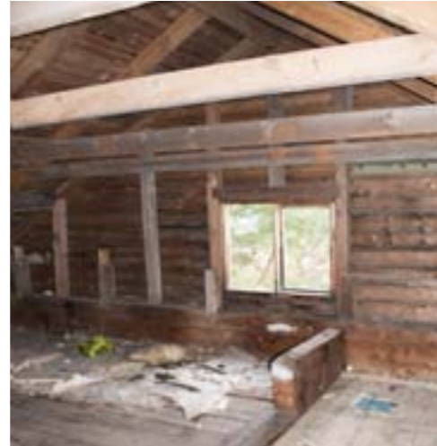
Kuva 2. Kuva etelän puoleisesta päädyistä. Päädyn ikkunan lasit ovat rikkoutuneet.
