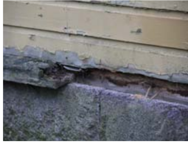
I: Alahelman vesilista puuttuu kokonaan. Kaikki vesilistat täytyy uusia koko rakennuksesta. Oikeaoppisessa rakennuksen kunnossapidossa vesilistat pitäisi uusia tiuhempaan, vähintään kymmenen vuoden välein, mutta aina tilanteen, kunnon ja julkisivun ilmansuunnan mukaan.
