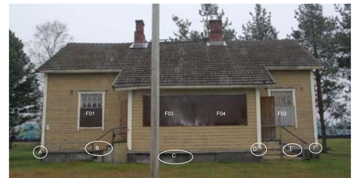
Julkisivu länteen. Yleisesti julkisivu on aika hyvässä kunnossa, mutta kuistin portaiden kohdalla julkisivuun kohdistuu suurempi kosteusrasite mikä on aiheuttanut paikoitellen jo vaurioita.
