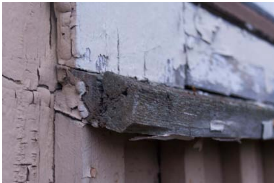
Ikkunan vesilauta on murtunut ja lahonnut
