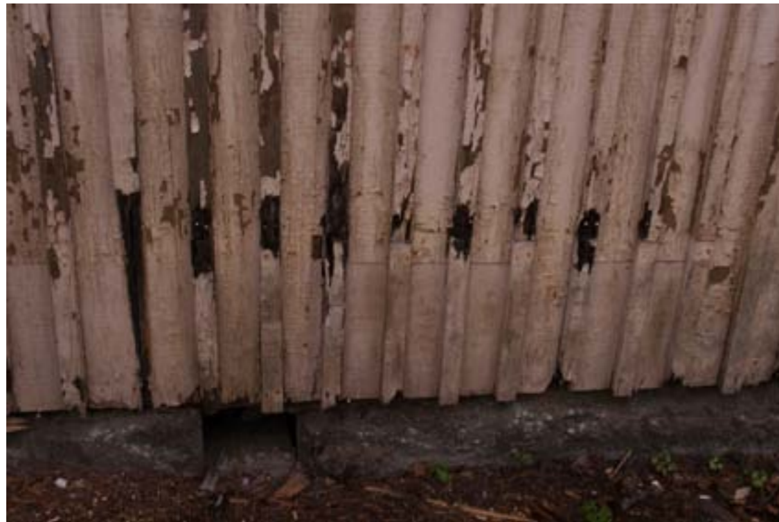
Julkisivun alareunojen lahovauriot tulisi korjata julkisivukunnostusten yhteydessä ja muuttaa puskusaamaan asennetut jatkokset viistotuiksi.
