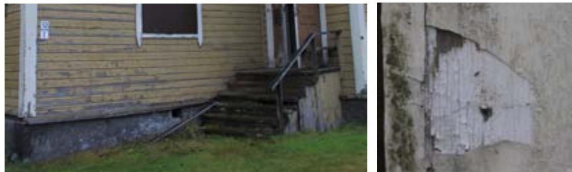
B, E: Julkisivu on portaan takaa kostunut ja osittain jo laho puuteellisen vedenpoiston seurauksena. Kosteusvaurio kokonaisuudessaan täytyy kartoittaa hyvin, poistaa sen aiheuttajat ja sitten korjata vauriokohdat. Vaurio todennäköisesti yhtyy alapohjan vaurioon, joka löytyi wc:n ja keittiön vesipisteiden välistä.
