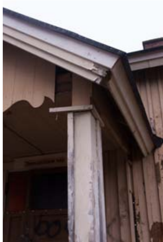
Kuistin etujulkisivusta puuttuu koristelaudoitusta
