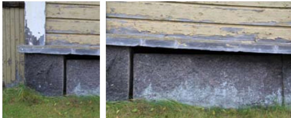
A, D, F: Nurkkalautojen alapääst kosteusvaurioiset ja maalipinta on kulunut. Osassa nurkkalautoituksista on lahoa tai ovat halkeilleet. Alahelman vesilista on osittain lahonnut.
