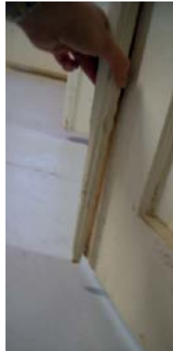
kuva E5 Ruokasalin ja salin välisen oven välilistä repsottaa (H105)
