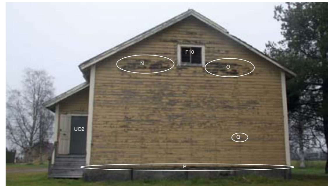
Eteläinen julkisivu on huonoimmassa kunnossa. Maali on hyvin kulunut ja hilseillyt. Julkisivun yläosassa, ullakon kohdalla julkisivulaudoitus on mustunut. Laudoitus on todennäköisesti lahonnut pahasti mustuneilta osilta.
