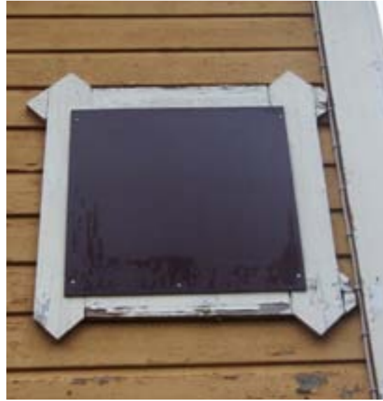
Liite 1: Sähköasennusten tieltä on leikattu ikkunoiden vuorilautoja.
