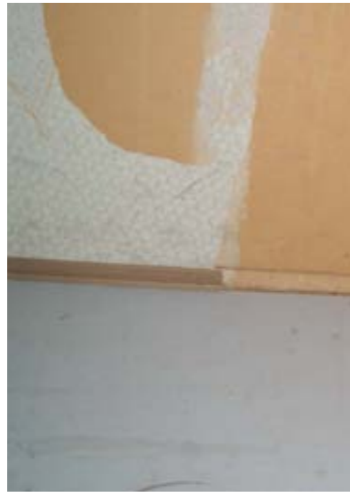
Kuva E3 Salin lattilista osittain poistettu, huonossa kunnossa/poistettu (H104)
