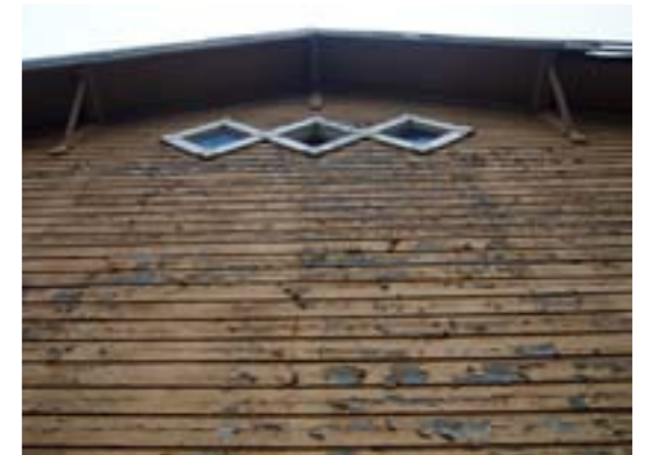
Liite 10: Maali on kauttaaltaan hilseillyt eteläjulkisivulla.
