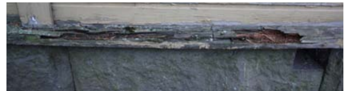
L: Alahelman vesilista kosteusvaurioitunut, lohkeillut ja kasvaa paikka paikoin sammalta.
