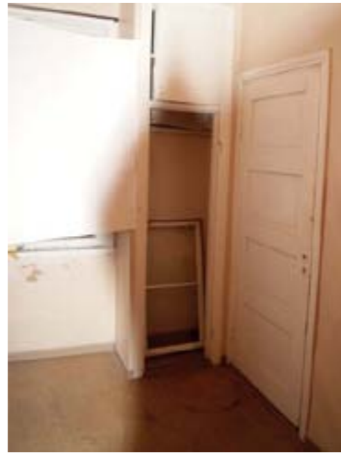
Kuva E31 Rikkoutunut lasi on nostettu kiinteään komeron sisään. Komerosta puuttuu ovi (H108)
