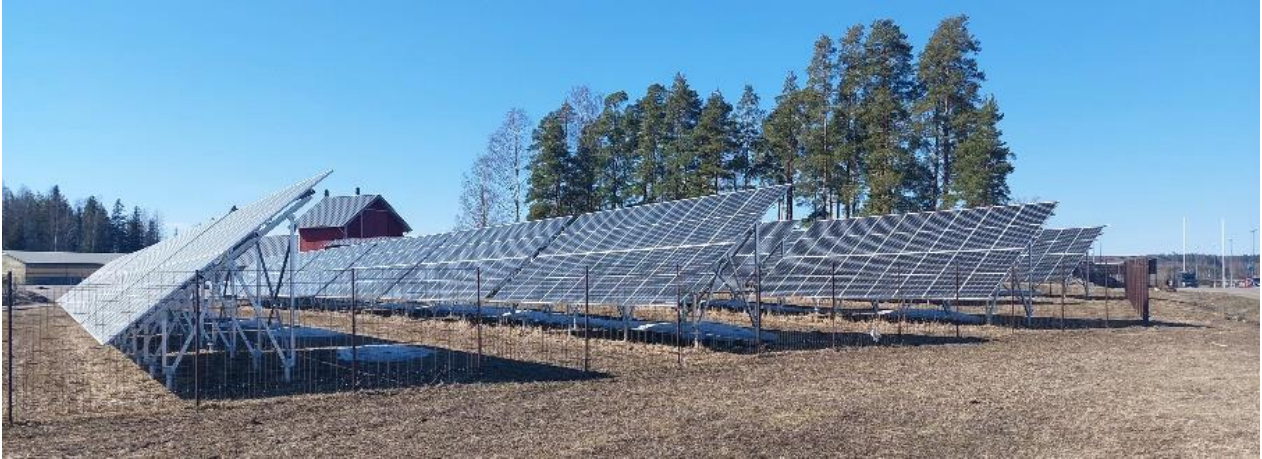
Kuva 13. Aurinkopaneelikenttä (Lähde: Solmar Consulting)
