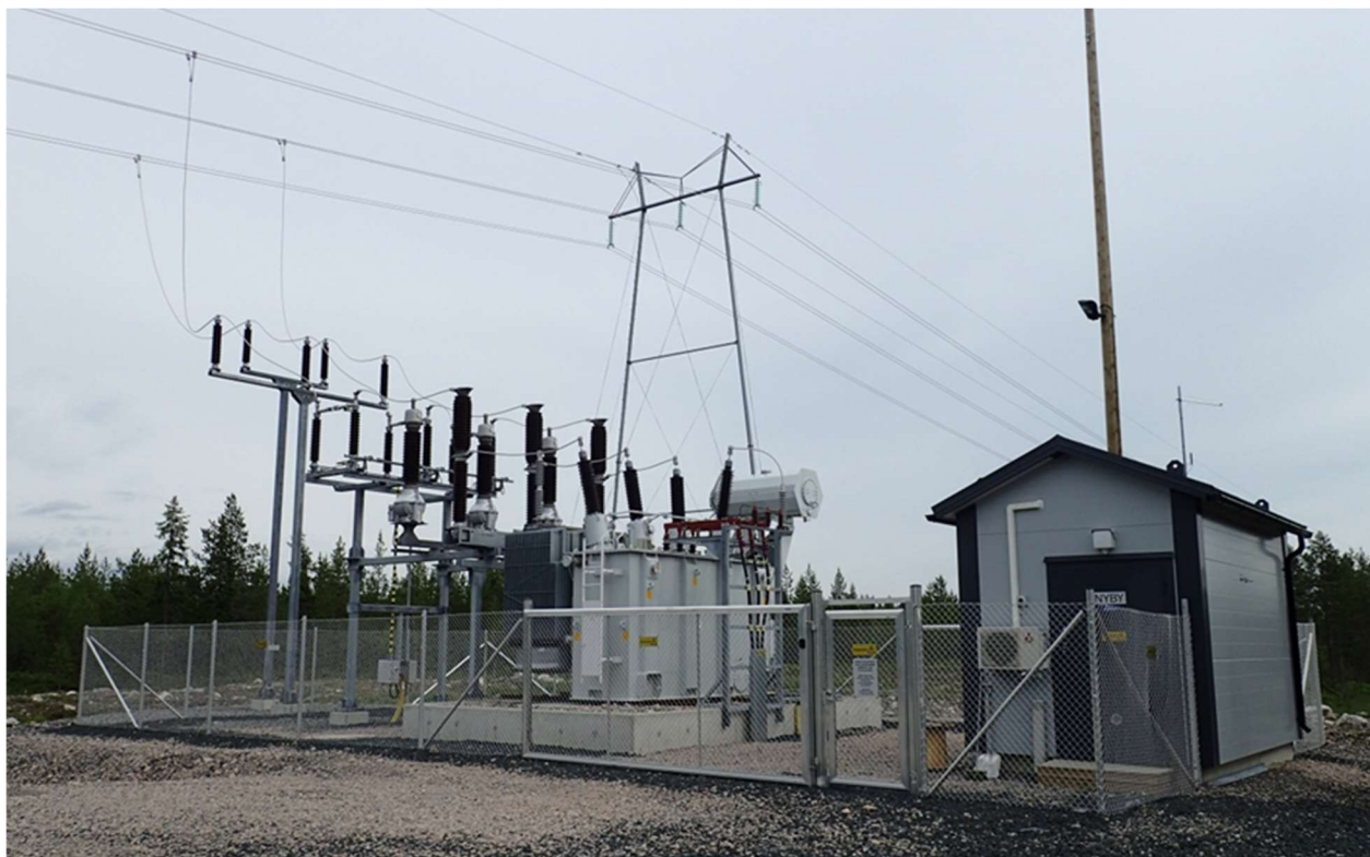
Kuva 72. Esimerkki tuulivoimapuiston sähköasemasta (kuva: FCG).
